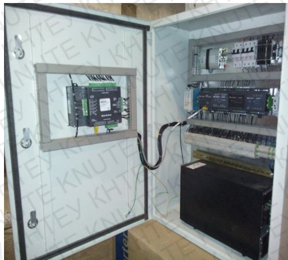
Рис. 2.8. Блок управління автоматичної системи теплоутилізатора УТКП-0,7 ТОВ «СТІКС-ОІЛ ІНЖИНІРИНГ»
